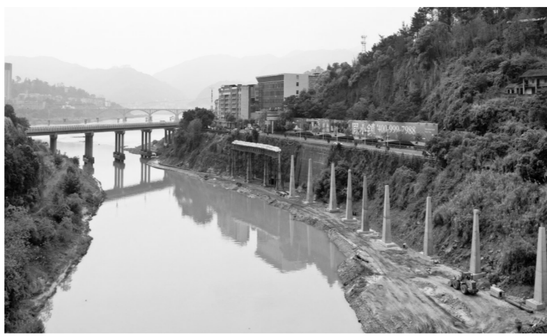
梅溪休闲栈道建设工程项目施工现场,工人们正在紧张有序地进行施工。
